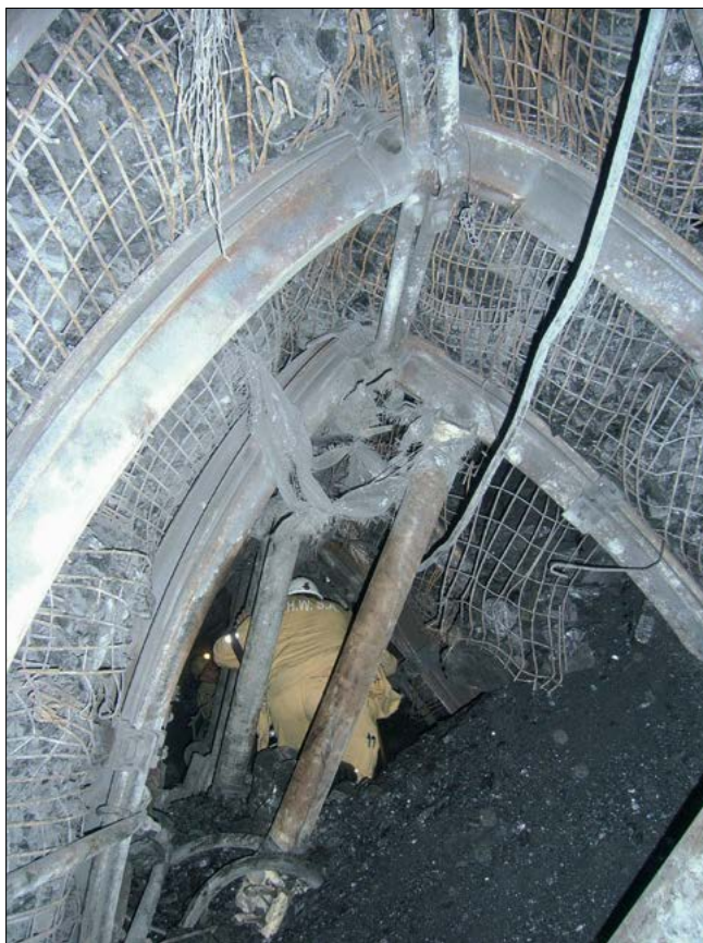
Fot. 1. Skutki zawalenia się chodnika
