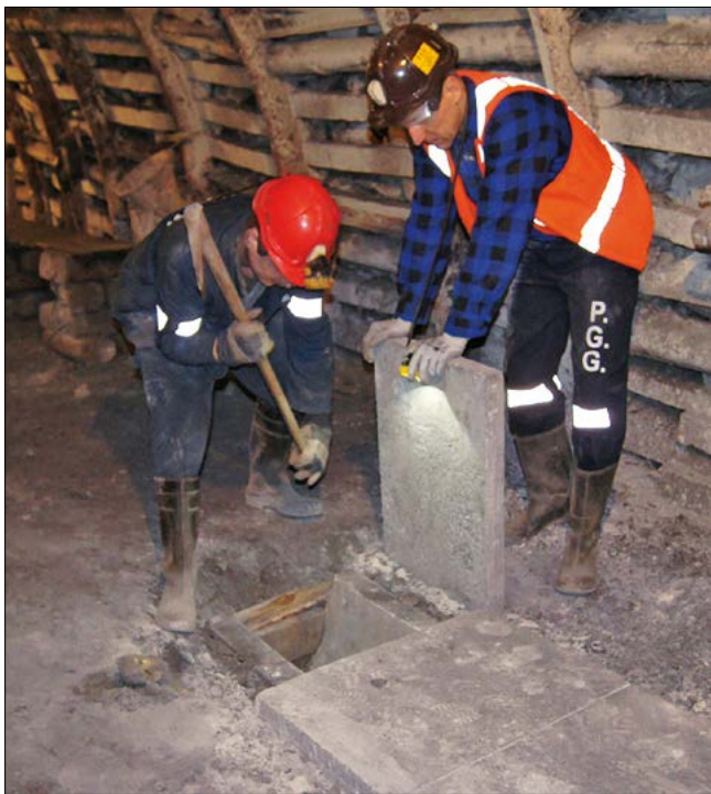
Fot. 11. Ściek kopalniany
