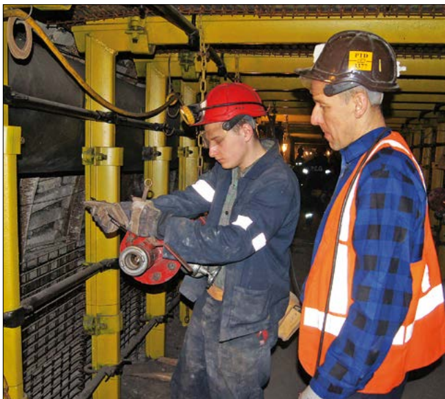
Fot. 8. Rurociąg przeciwpożarowy
