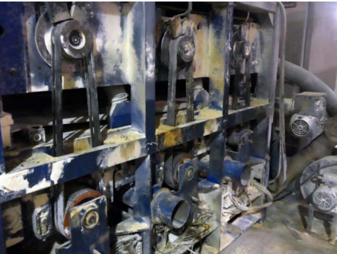
Fot. 2. Widok na napęd szlifierki po oderwaniu osłon w wyniku wybuchu.
