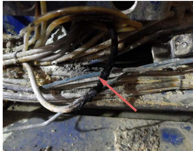
Fot. 3. Zwęglone przewody sterujące szlifierki.
