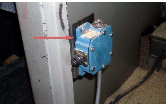
Fot. 3. Pilarka optymalizująca - urządzenie blokujące zainstalowane przy osłonie ruchomej znajdującej się w dolnej części maszyny.
