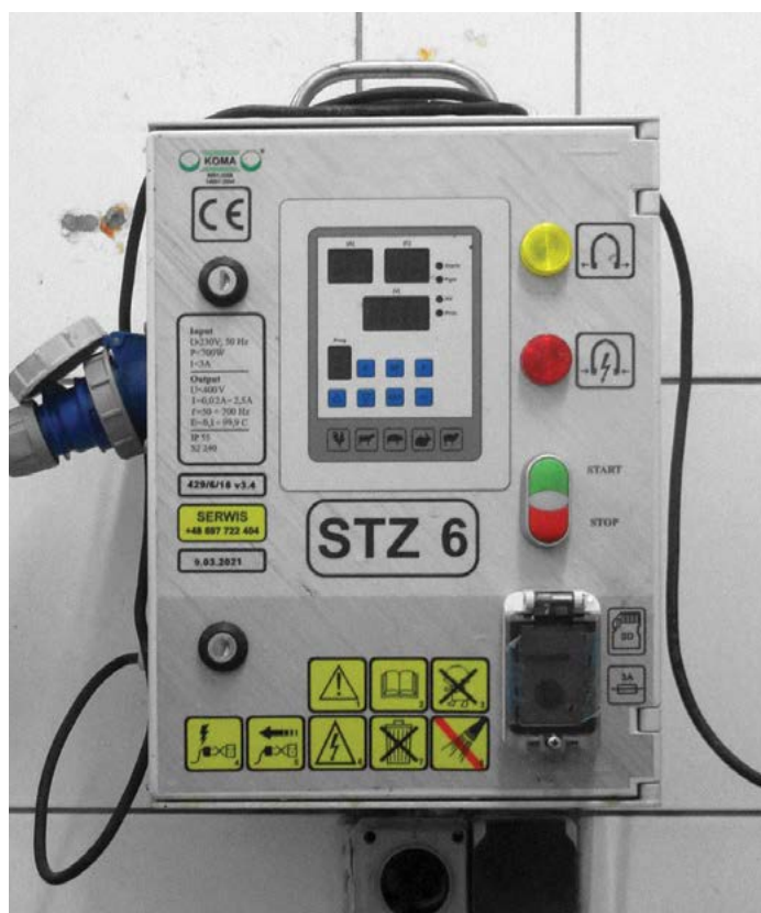
Fot. 4 Zabezpieczony przed uruchomieniem zasilacz sieciowy z transformatorem separacyjnym.
